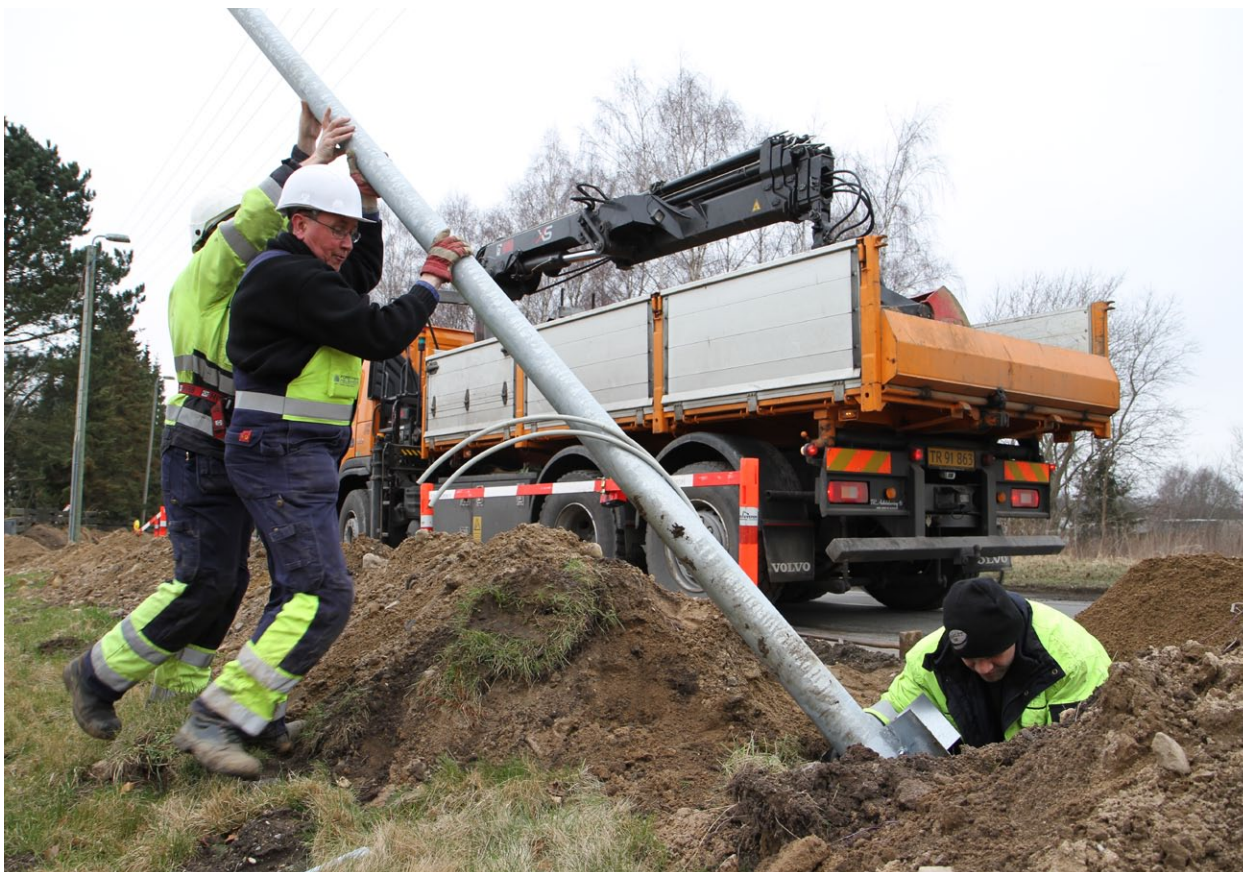
Gadebelysningen blev moderniseret samtidig med, at nye el-kabler blev lagt i jorden.
